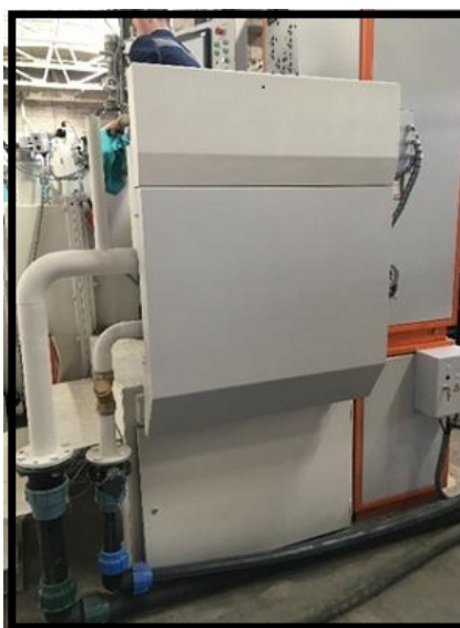
Рисунок 10. Система водяного охлаждения
