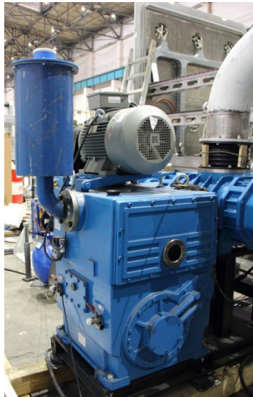
Рис. 20. Насосы низковакуумной станции
