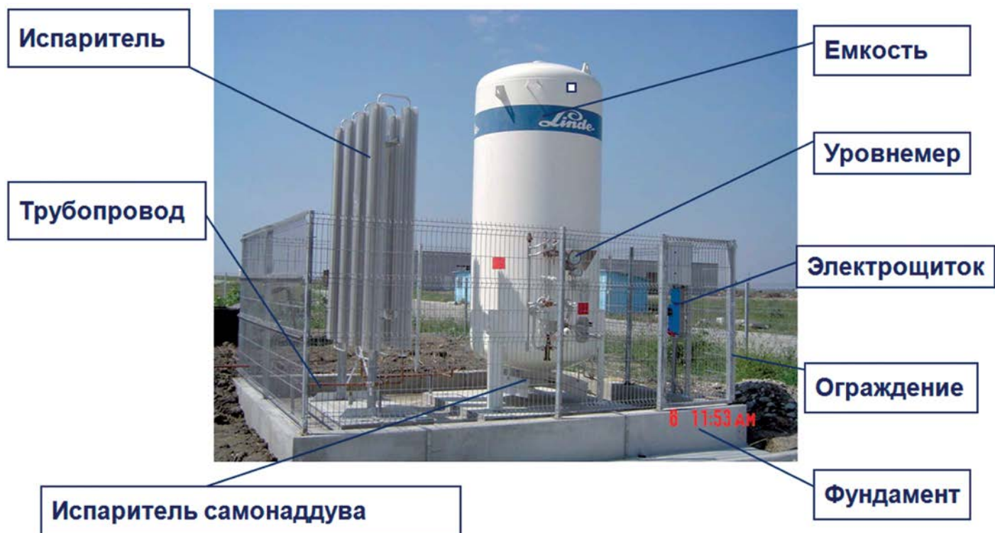
Внешний вид газовой станции
